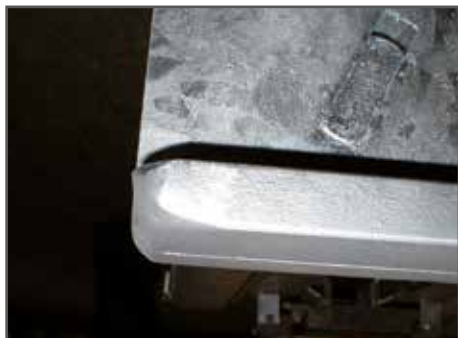
sivukiskon laakeripinta on pyörästetty
